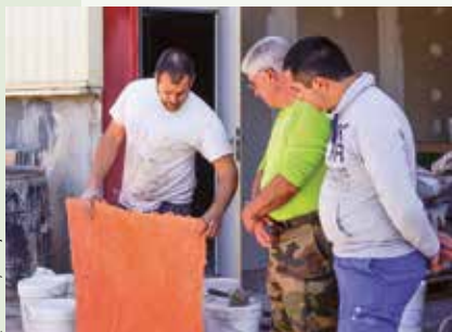
Deux jours de stage pour découvrir les techniques de pose des bétons décoratifs.
